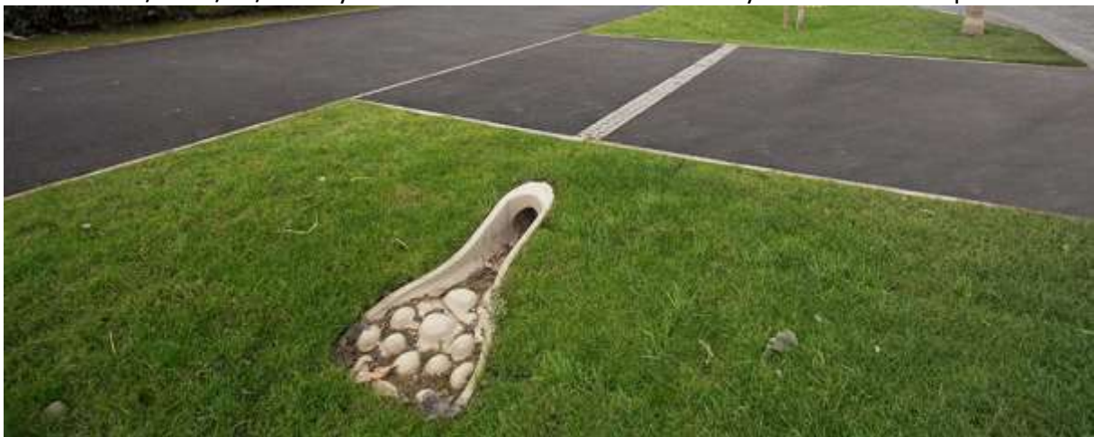
17.kép: surrantós pontszerű bevezetés a biovápa végében erózióvédelmet biztosító, áramlást kiegyenlítő előregyártott ACO elem alkalmazásával ( https://www.aco.co.uk/products/suds-swale-inlet )
