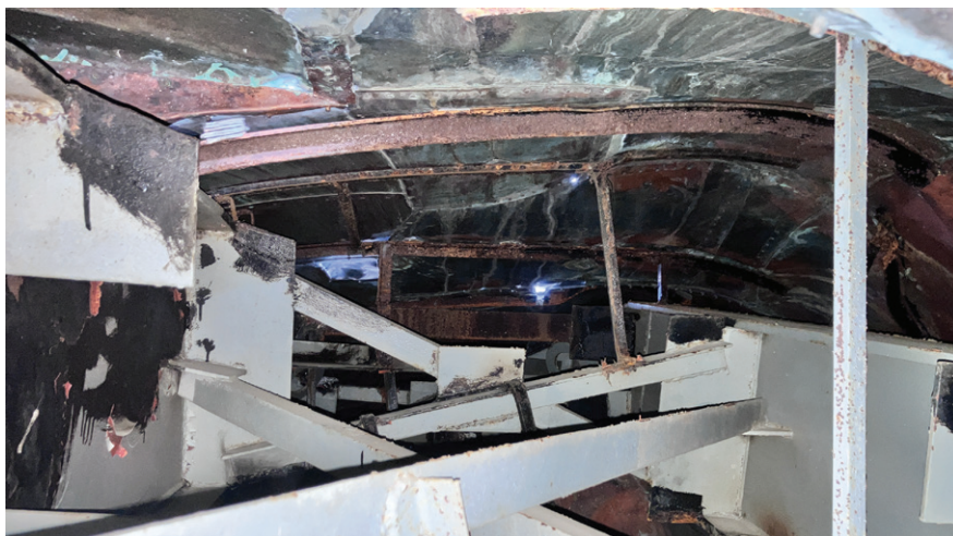
A szerkezet rétegződése a bal oldali szárnyban: az elsődleges tartóváz, a korrodált másodlagos szerkezet és a bronzlemez héj
