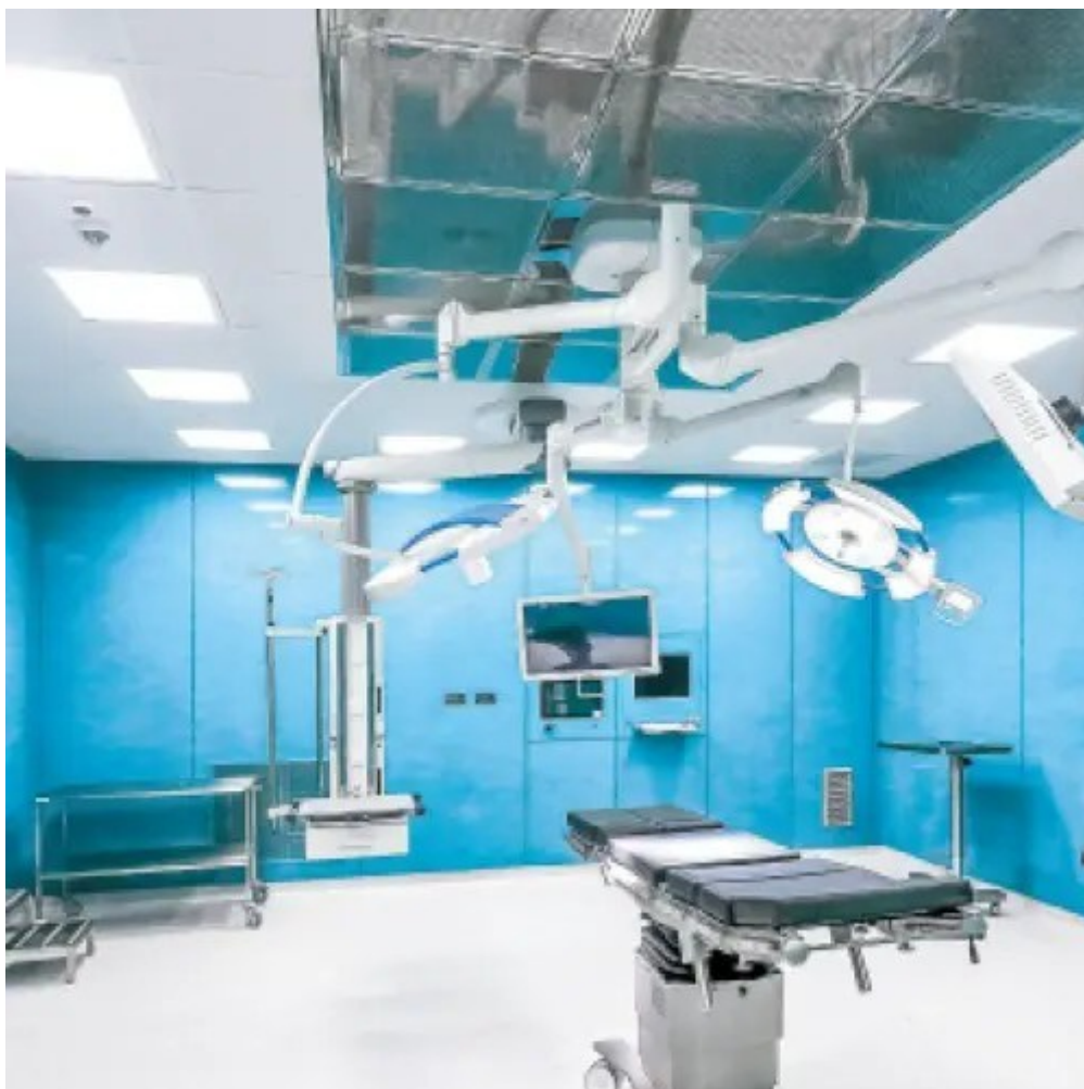
25. ábra Panel műtő rozsdamentes oldalfali elemekkel
