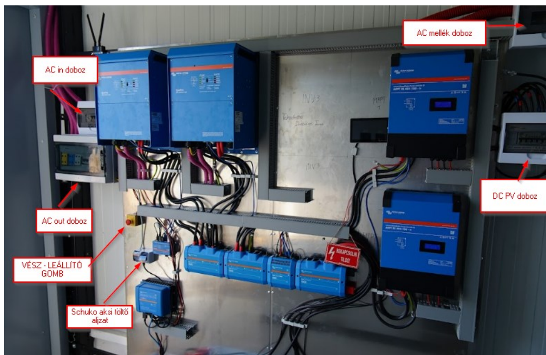
37. ábra. A kiépült rendszer [saját készítésű]
