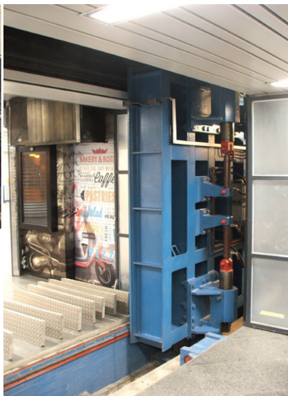
Állomási elzáró (csarnok) kapuzárás közben
