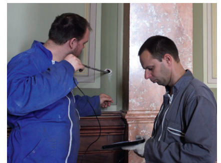
4. kép A díszterem falazatának vizsgálata - kamerás furatvizsgálat, magminták és a vegyes téglafalazat
