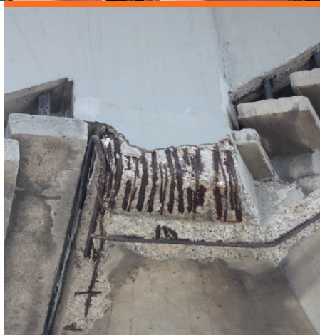
A főlépcső teherhordó vb. konzoljának betonkárosodása
