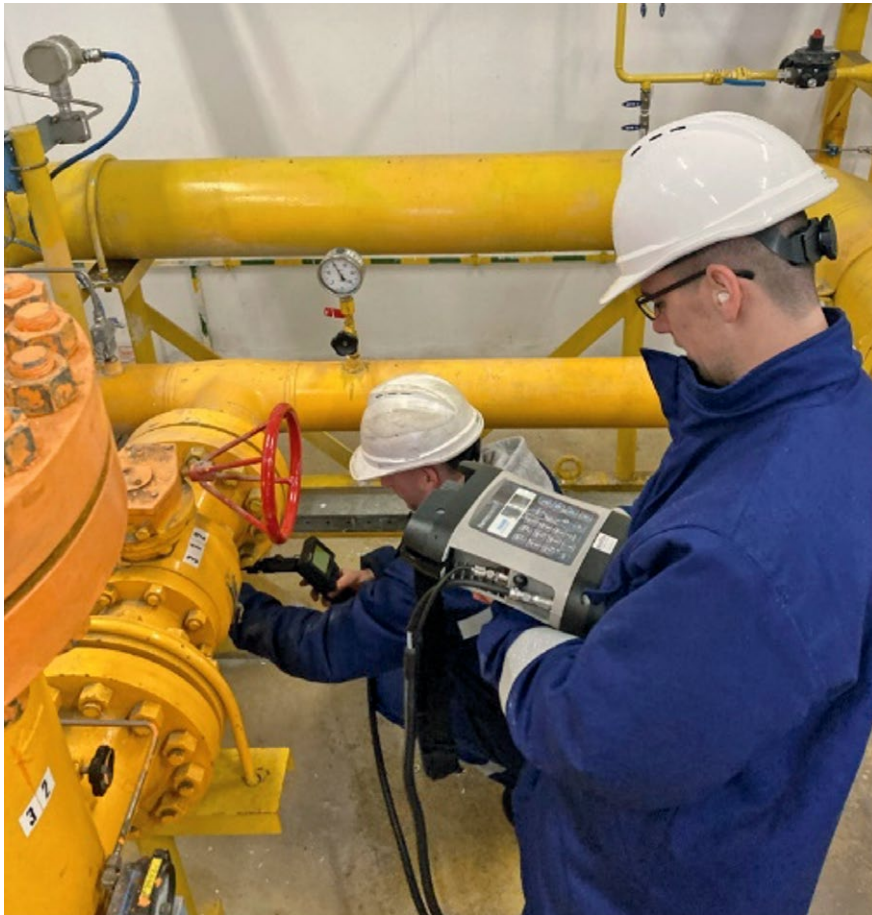
Áteresztő szerelvény keresése akusztikus műszerrel
