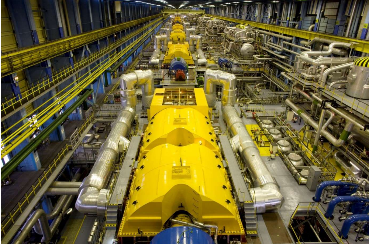
3-1. kép. A Paksi Atomerőmű turbina csarnoka, előtérben a turbinával [28]
