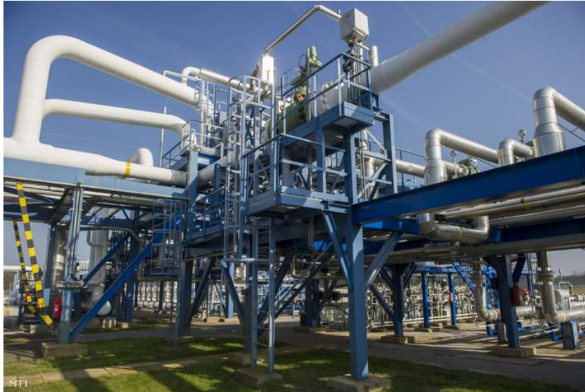
2-5. ábra. A zsanai földgáztároló földalatti tárolótelepének felszíni infrastruktúrája [46]
