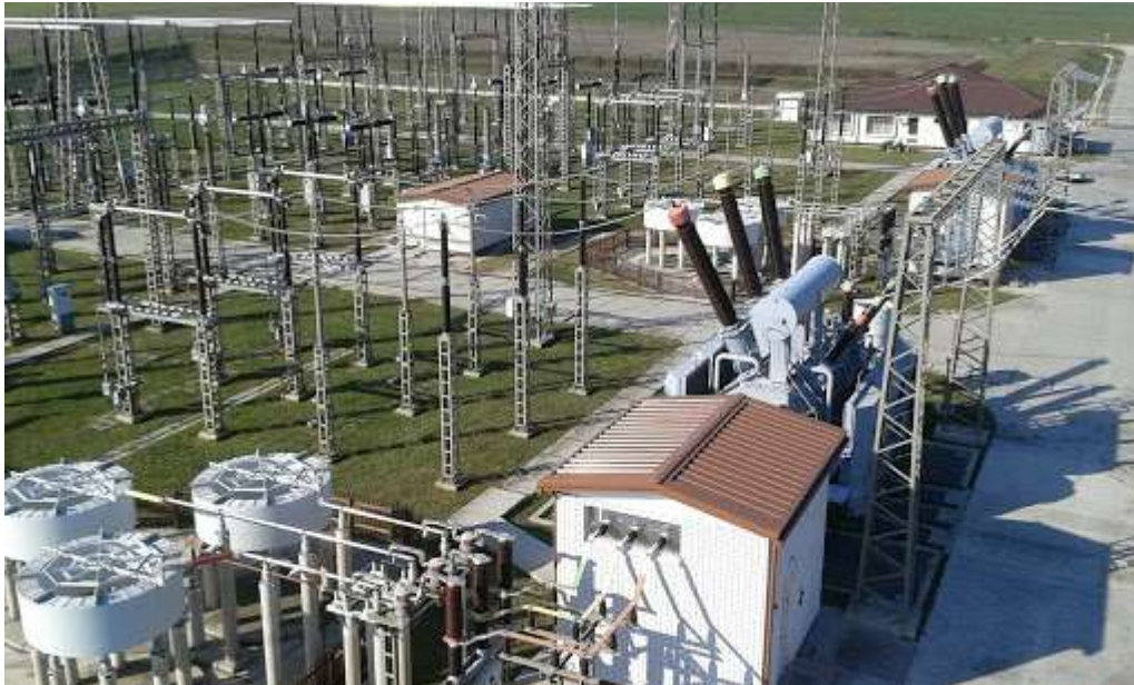
6-1. kép. 400 kV-os villamos alállomás [31]
