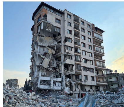
A házra omló szomszédos épület okozta részleges romosodás
