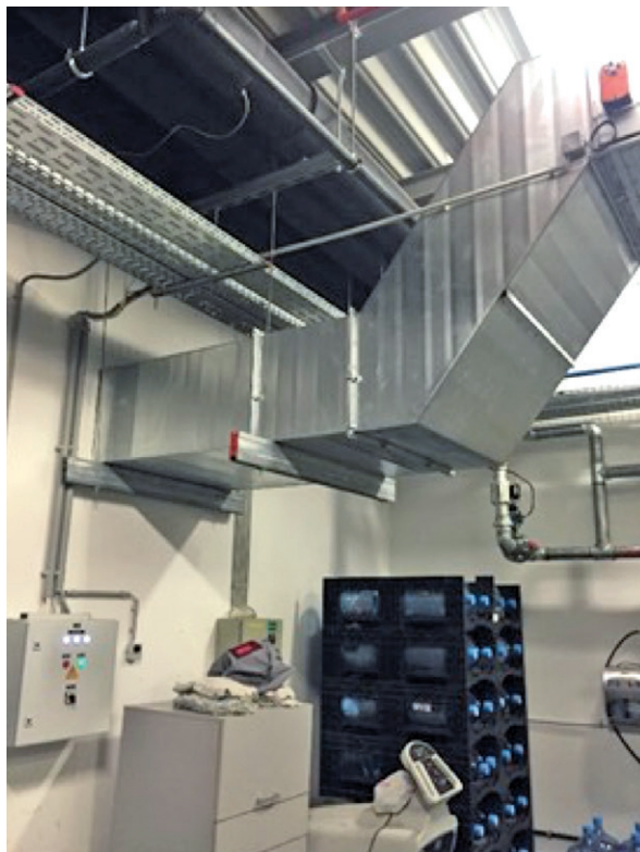
1. kép: A hűtőlevegő-csatorna bevezetése a gyártócsarnokba
