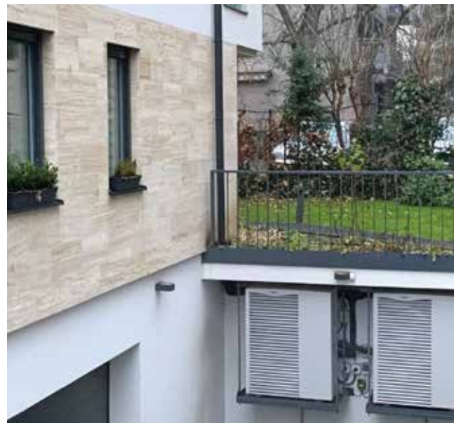
2. kép: A nyitott ablak és a hőszivattyú kültéri egysége
