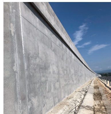
A képen az M30-as autópálya novajdrányi szakaszának támfalai láthatók, ahol 13 000 m 2 -re hordták fel a Planiseal WR 85 gél
