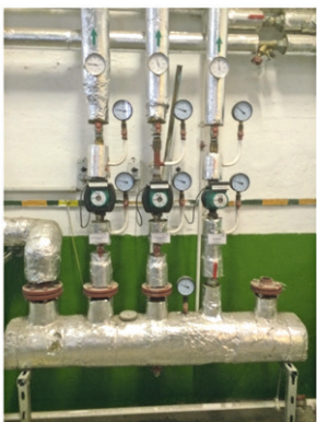
5. ábra: A 4. sz. hőközpont osztója a szekunderkörtől keringtetőszivattyúkkal
