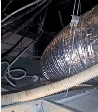
Tűzvédelmileg aggályos gépészeti elem zsíros levegő elvezetésére
